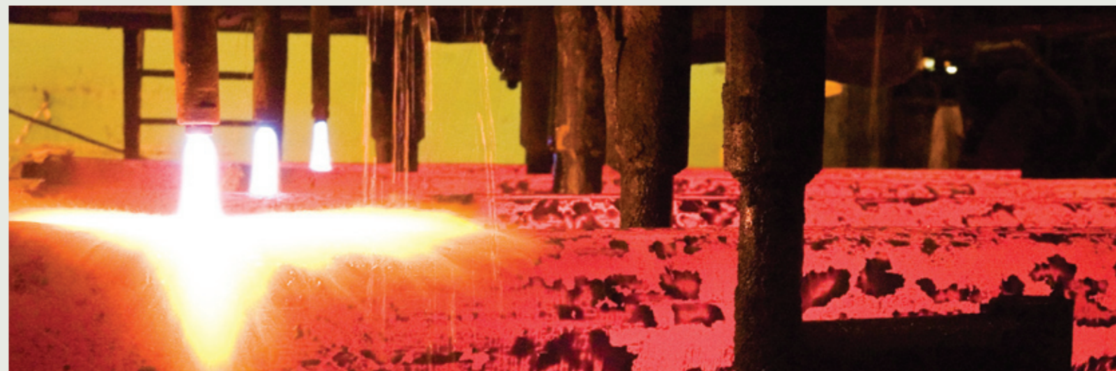
NA SIDERÚRGICA DA VSB, A EPC TEM COMO MAIOR DESAFIO DESENVOLVER OS PROJETOS PARALELAMENTE À EXECUÇÃO DA OBRA
